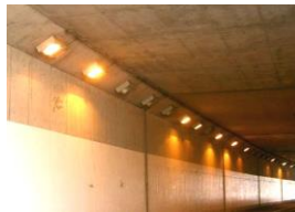
トンネル内照明
